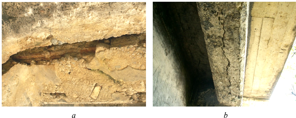
a – полностью сгнившая арматура ригеля второго отсека; b – расслоение бетона и образование трещины на нижней грани восточного борта лотка второго отсека a – completely rotted fittings of the crossbar of the second compartment; b – stratification of concrete and formation of a crack on the lower edge of the eastern side of the tray of the second compartment
