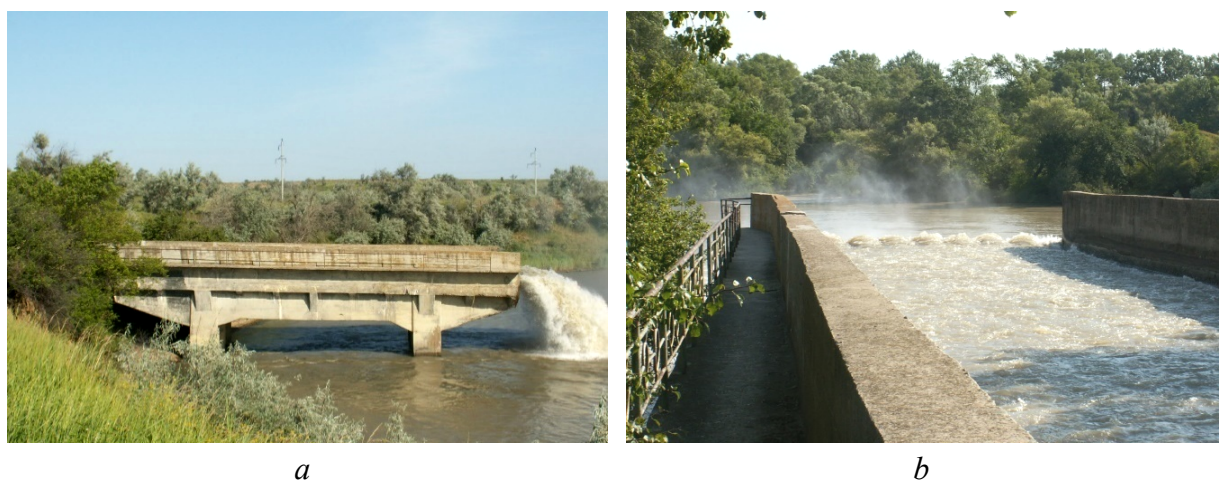
a – общее техническое состояние железобетонных конструкций концевого водоспуска; b – на бортах лотка видны следы заделки трещин и деформационного шва цементным раствором
