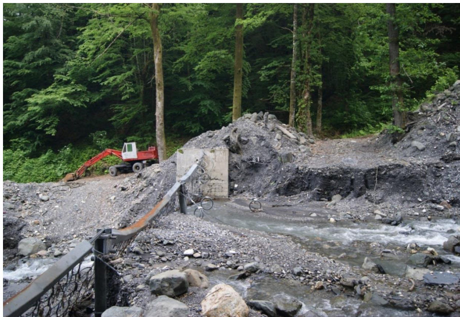
Рисунок 2 – Состояние ведомственного селезащитного сооружения (фото О. Н. Гетто)
