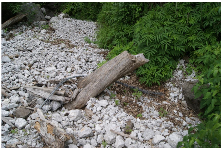
Рисунок 3 – Состояние бесхозяйного селезащитного сооружения (фото О. Н. Гетто)
