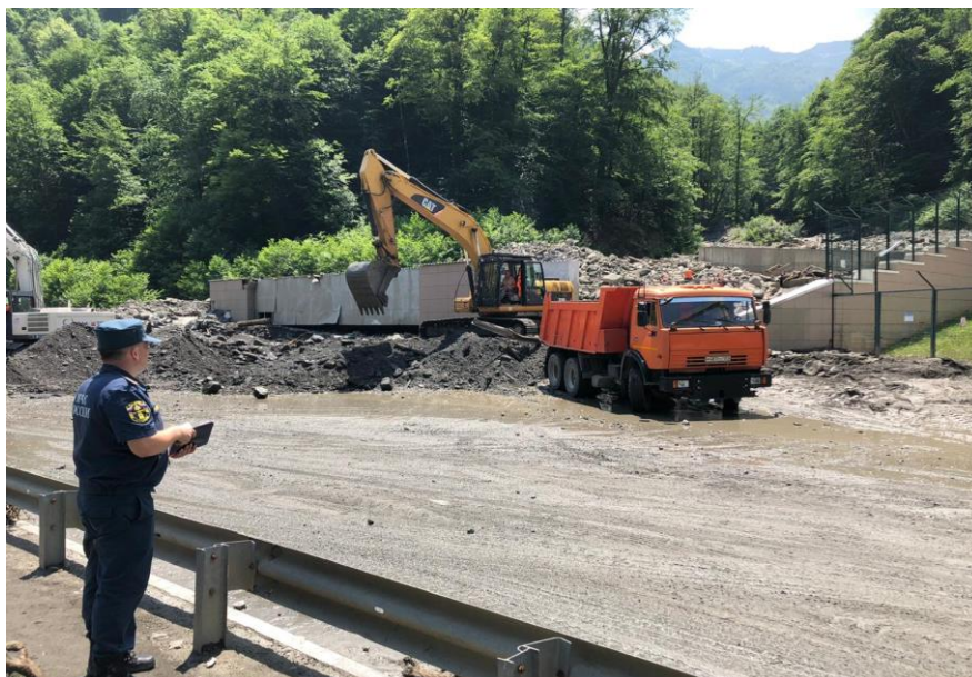
Рисунок 1 – Последствия схода селя на автодороге в районе Сулимского ручья (фото О. Н. Гетто) Figure 1 – Consequences of mudflow on the road near the Sulimsky stream (photo by O. N. Ghetto)
